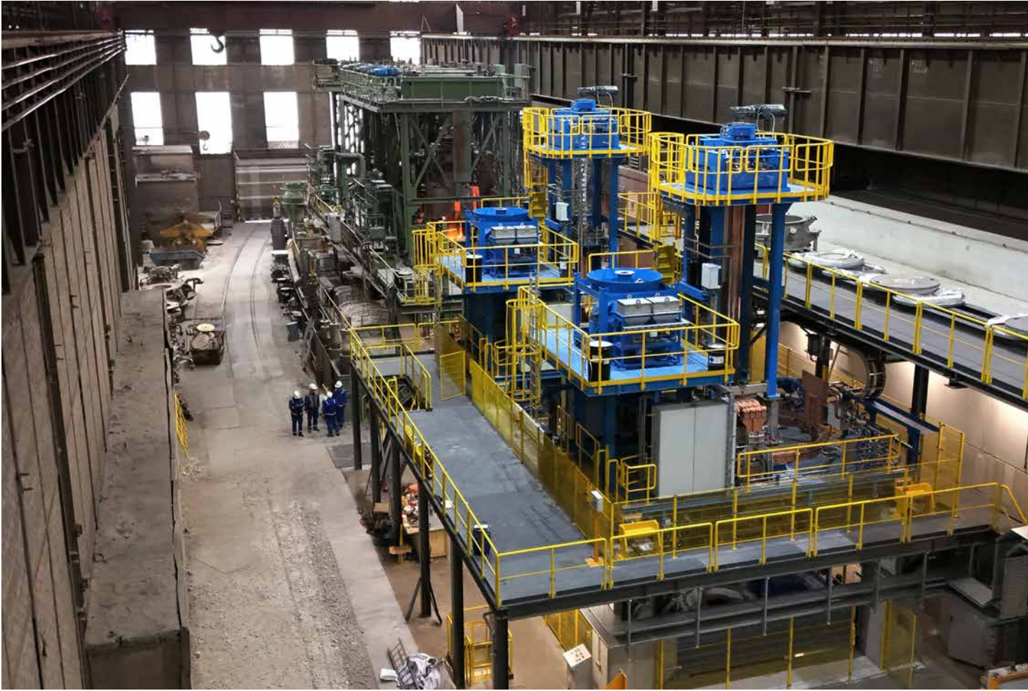
85t ESR furnace in operation now at Schmiedewerke Gröditz
